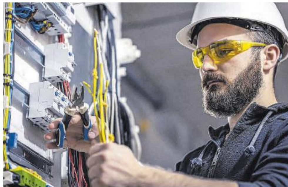
Un tècnic portant a terme una revisió en un comandament elèctric d'un habitatge. | DDG
